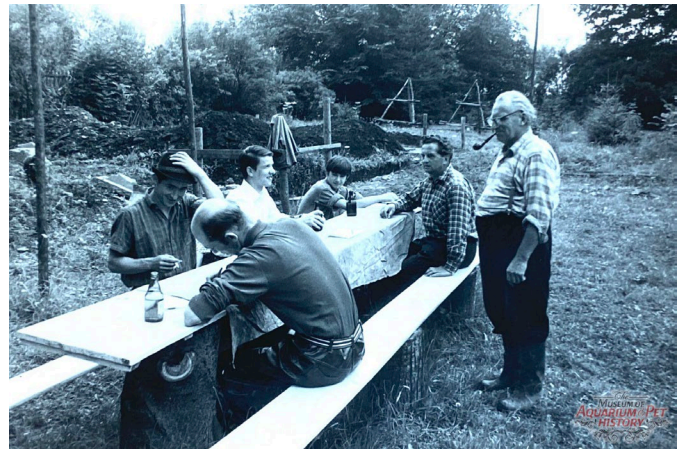
Hier entsteht unter der Leitung von Charly Fuchs (rechts) das Fundament für die neue Baracke
